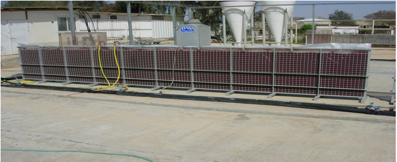
Production algal extérieur en panneau vertical
